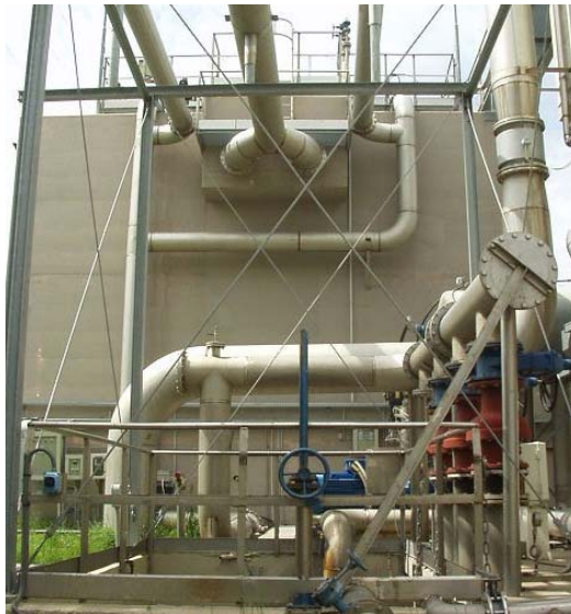
Figura 63 - impianto di sollevamento
