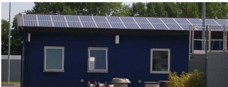
Figura 30 pannelli fotovoltaici sugli edifici del depuratore
